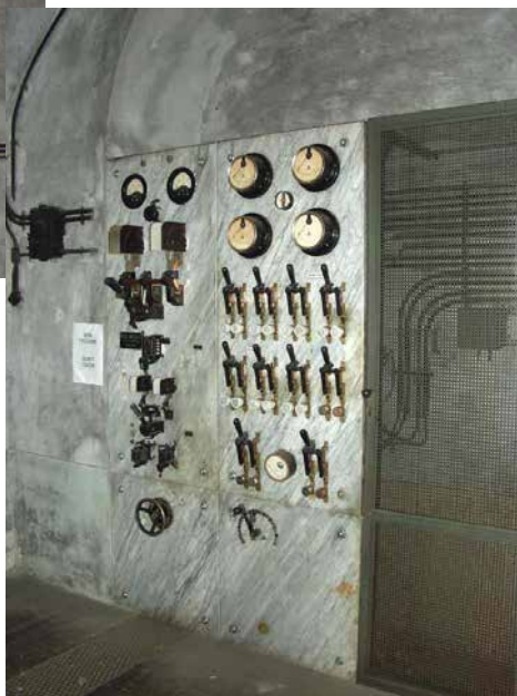
Quadro elettrico principale
