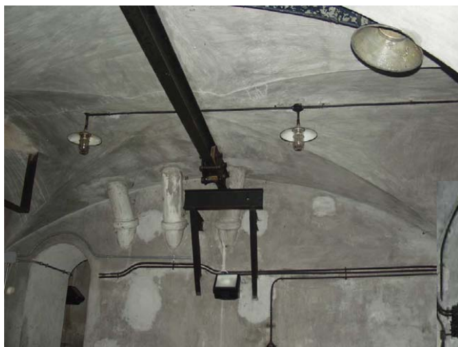
Particolare del soffitto con l'impianto di illuminazione
